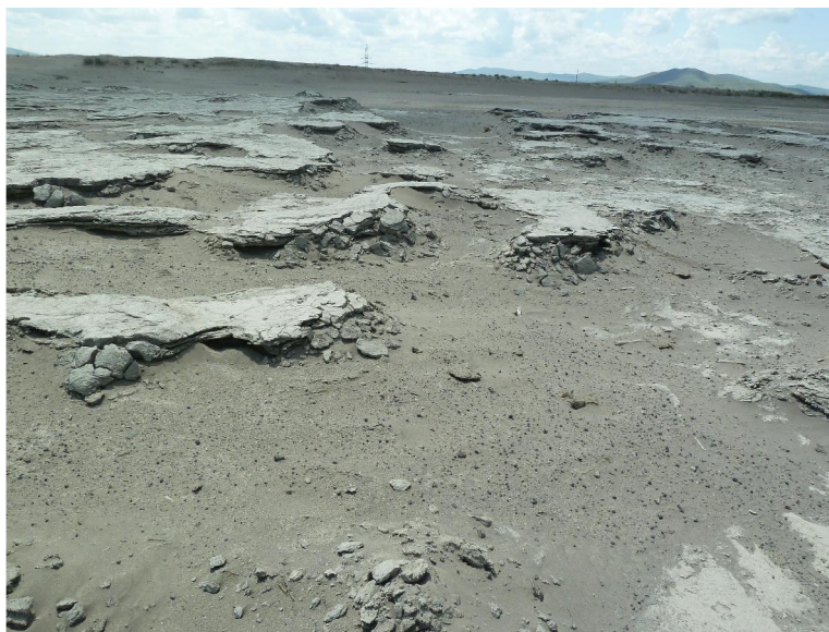
Рис. 1. Размытая временными водными потоками поверхность хвостохранилища / Fig. 1. The surface of the tailings dump eroded by temporary water flows
