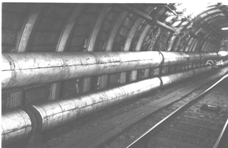
Рис. 3. Общий вид выработки с теплоизолированными трубопроводами
