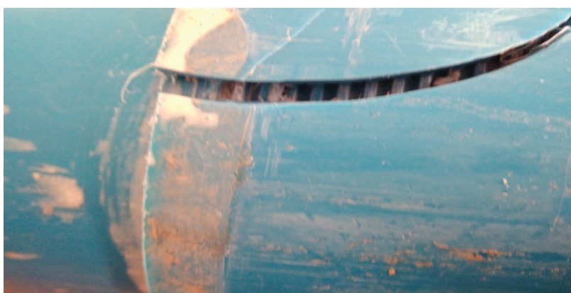
Рис. 4. Вариант разрушения муфтовой части резьбы труб НПВХ / Fig. 4. Variant of the coupling part destruction of the thread of NPVC pipes
