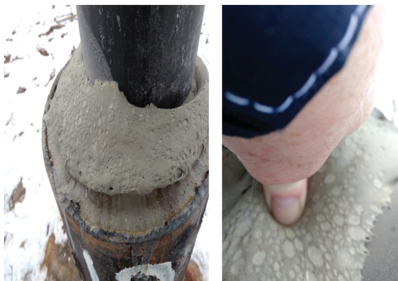
Рис. 9. Устье технологической скважины, оборудованное вязкоупругим материалом (температура окружающего воздуха – 20 °С) / Fig. 9. Process well mouth equipped with viscoelastic material (ambient temperature – 20 °С)
