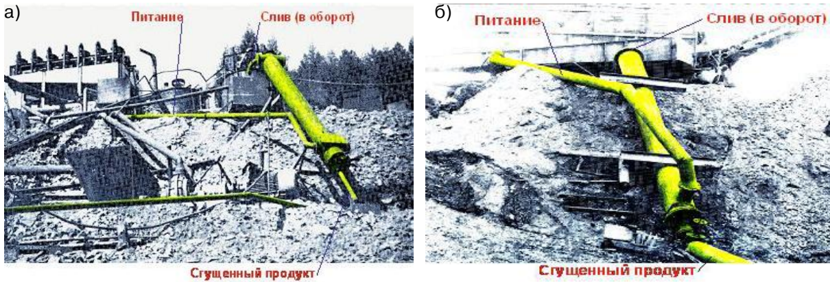
Рис. 3. Тонкослойные аппараты в системе водоподготовки: а – питание от слива гидроциклонов; б – питание от слива шлюзов / Fig. 3. Thin-layer devices in the water treatment system: a – power from the discharge of hydrocyclones; b – power from the discharge of locks
